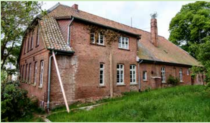
Der deutlich verwitterte hintere Teil des Gebäudes ...
