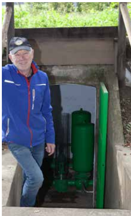
Hier geht es hinunter zum Herzstück der Anlage. Klaus Voigts hat sie uns gezeigt.
