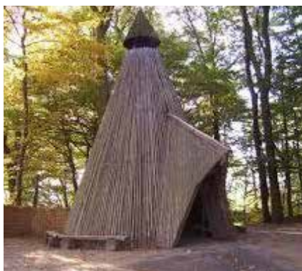
Die Gödenstorfer Köhlerhütte braucht eine Sanierung: Ein Fall für das Dorf-Aktiv-Team!
